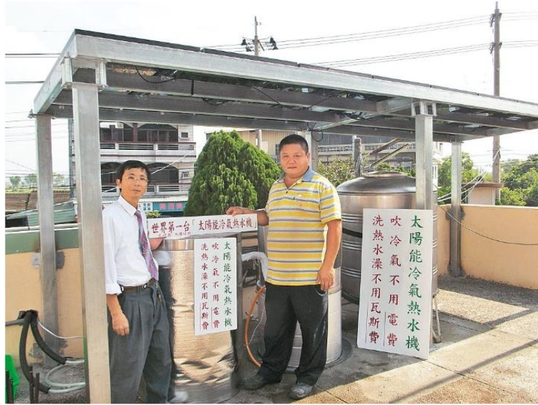
全台第一座太陽能冷氣熱水機裝置在興中社區活動中心。 記者謝恩得/攝影
